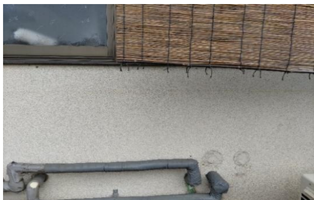
壁に残った水の跡
