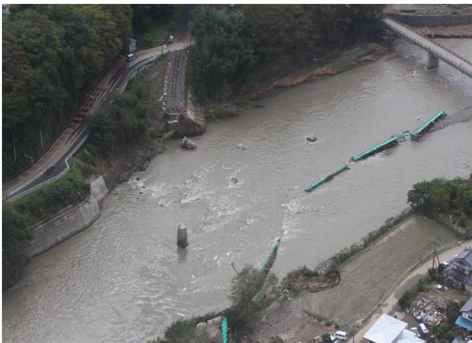
被災後の水郡線第六久慈川橋梁
