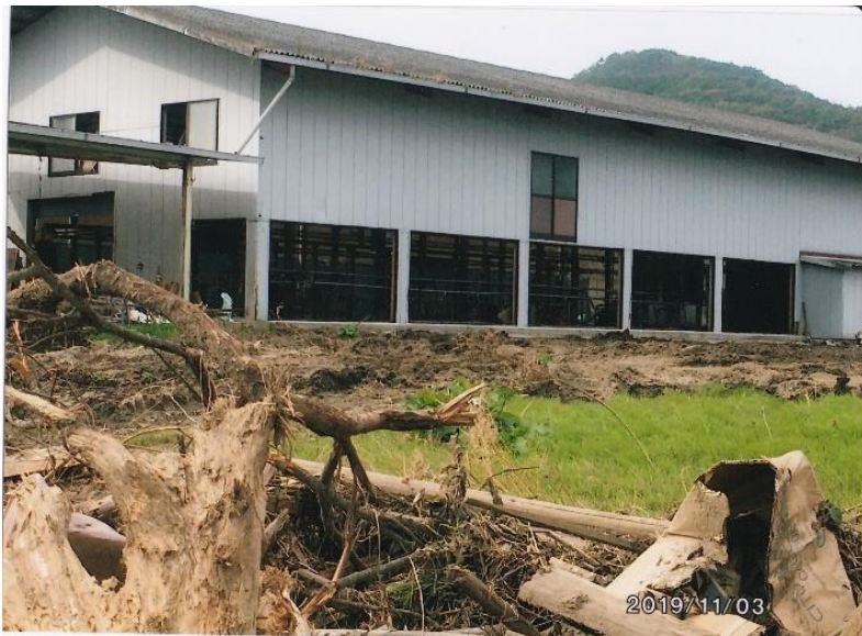
サッシの割れた牛舎
