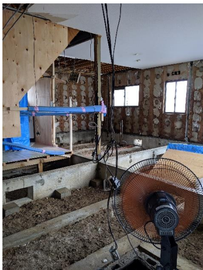
被害にあった家をリフォーム
